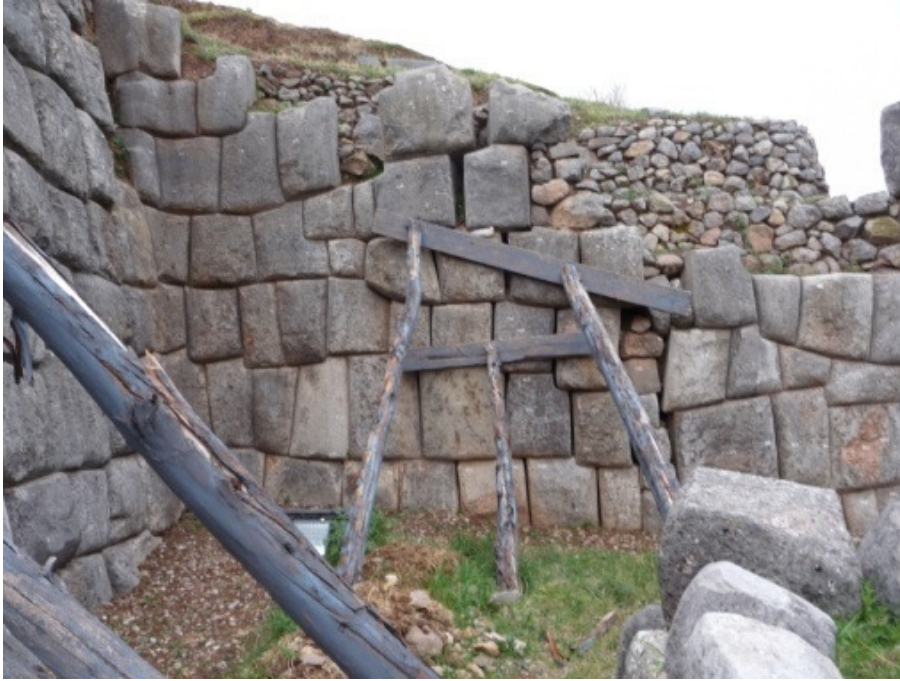
Foto 21. Muro con bloques con separación de juntas por presión lateral y asentamiento.
