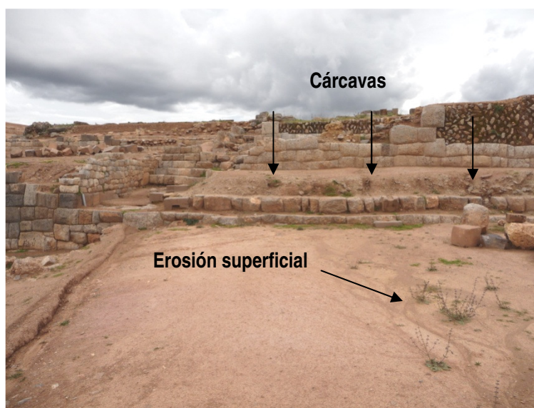
Foto 17. Erosión superficial de pisos y cárcavas asociadas.
