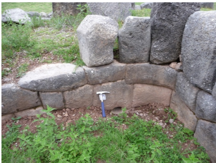
Foto 12. Drenaje en la esquina de un zigzag que coincide con el piso actual.
