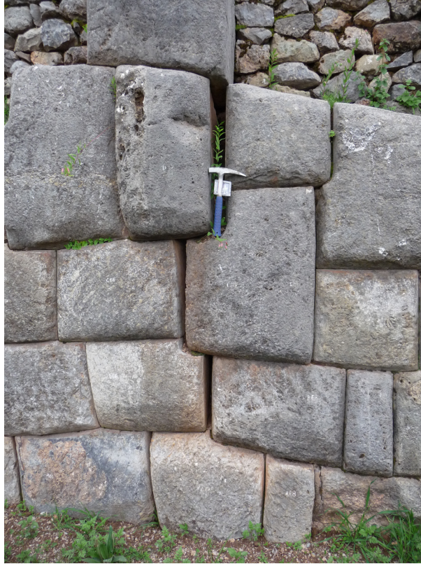
Foto 15. Muro afectado por empuje lateral y asentamiento.
