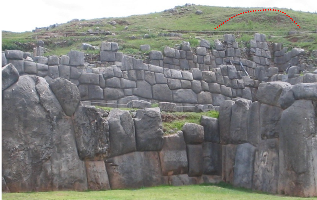
Foto 20. Zona de asentamiento donde hay acumulación de las aguas pluviales en relación a los daños en los muros.
